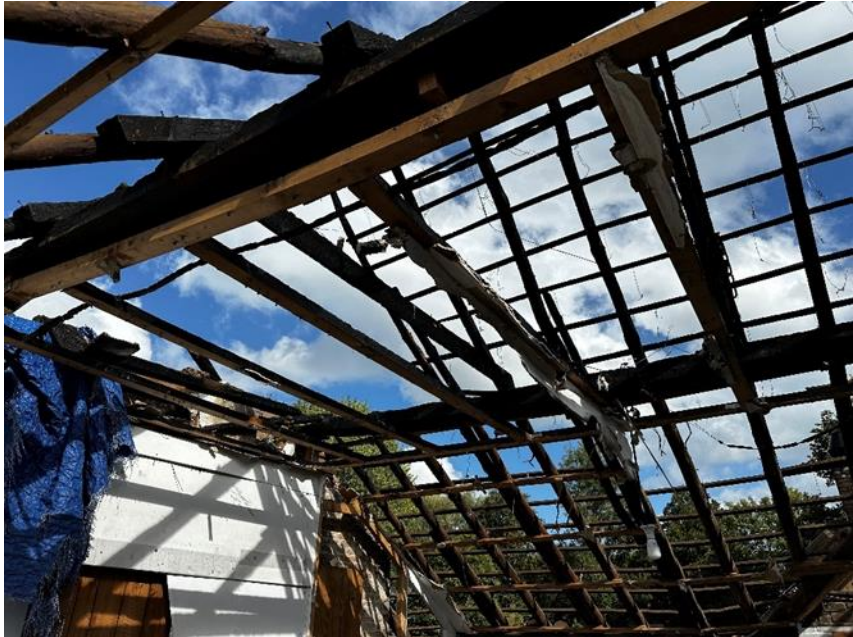
3.23 De kapconstructie boven het woongedeelte van de boerderij is deels behouden gebleven maar heeft veel brandschade
