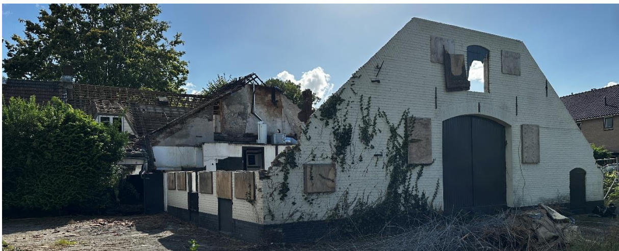
3.18 De boerderij met rechts de achtergevel, ter plaatse van het stalgedeelte ontbreekt het dak; links is de aanbouw
