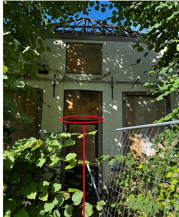
Figuur 3.26 De voorgevel is in de huidige situatie deels overwoekerd, de vensters zijn dichtgetimmerd
