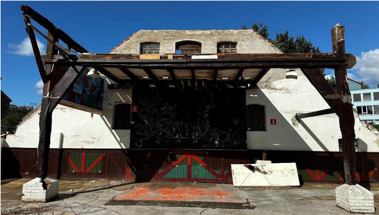
3.20 Het achterste ankergebint in het voormalige stalgedeelte dat de brand heeft overleefd
